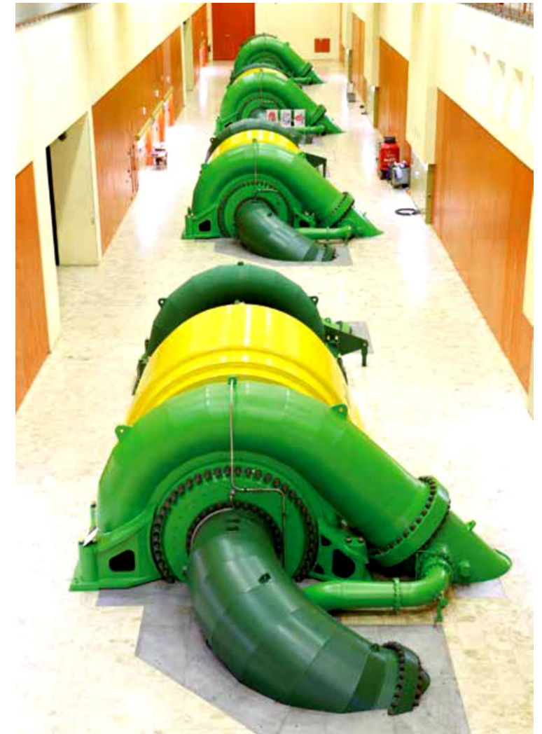
Centrale de Grimsel 2 équipée de 4 groupes ternaies
